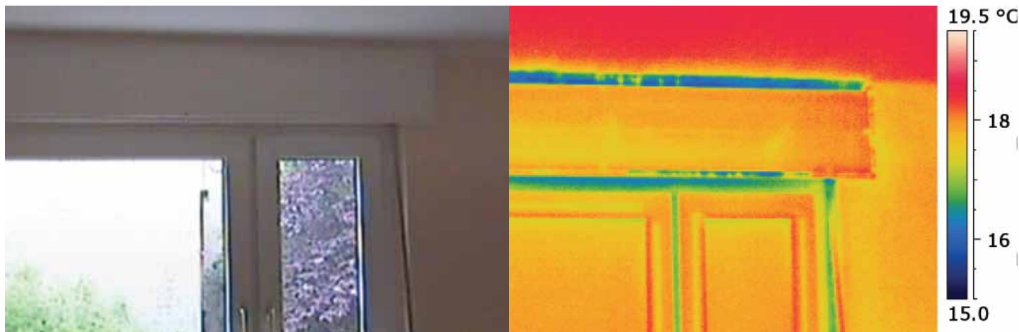
Esta ventana parece totalmente hermética, pero al hacer una prueba Blower Door con una cámara de imagen térmica FLIR se ve claramente la corriente de aire en la imagen térmica. Las mediciones con el anemómetro comprobaron que la corriente de aire era de 6,44 m/seg, una velocidad muy alta teniendo en cuenta que se consideran fuertes las superiores a los 2 m/seg.
